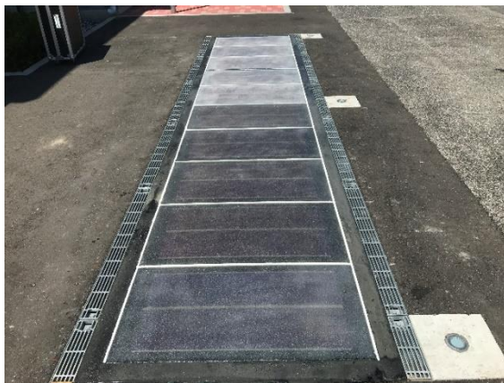
路面型太陽光発電パネル
